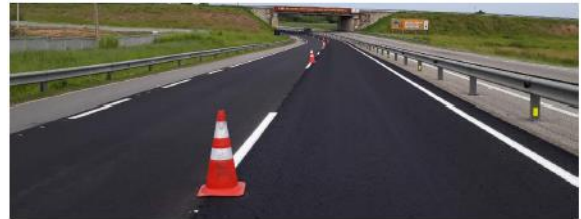
Figura 6.11 Via Lagos - Sinalização de segurança
